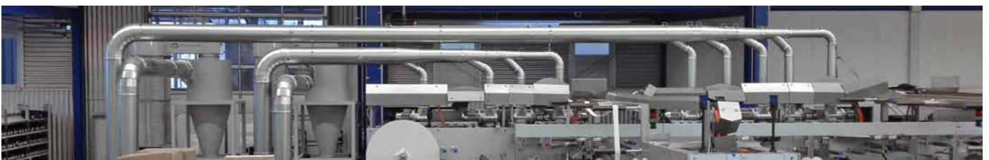
Zyklon mit Rohrführung an Maschine Cyclon with piping on top of the machine
