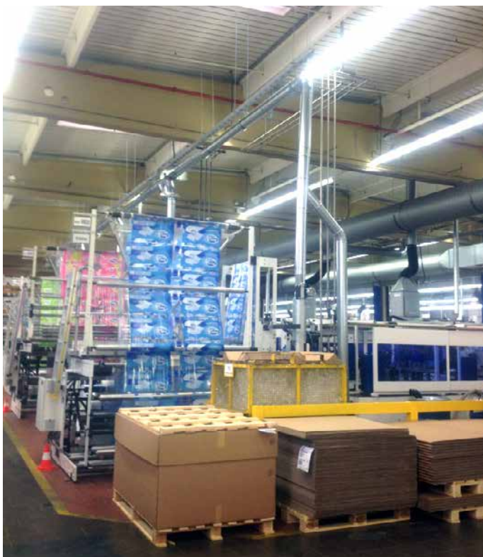
Rohrleitungssystem über den Maschinen Piping over the machinery
